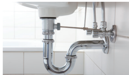
排水管 Water pipes
